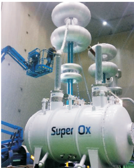
Рис. 6. Фаза ВТСП ТОУ на 220 кВ в испытательном центре KERI на этапе монтажа ошиновки перед высоковольтными испытаниями
